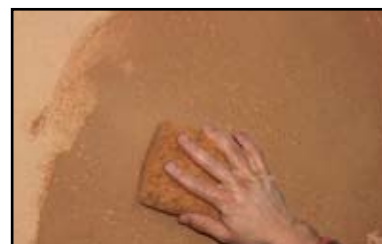
Etape 4 - une fois l'enduit sec, passage d'une éponge semi-humide afin de faire tomber les poussières de surface et faire ressortir le lin.
