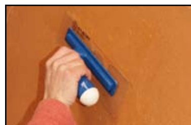
Etape 4 - à mi séchage, resserrer l'enduit à l'aide d'une spatule plastique souple.
